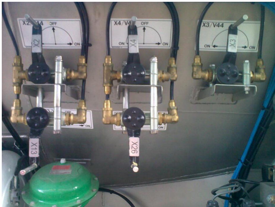
Kuva M6e. 1. Sulkuventtiilien ohjausventtiilit
